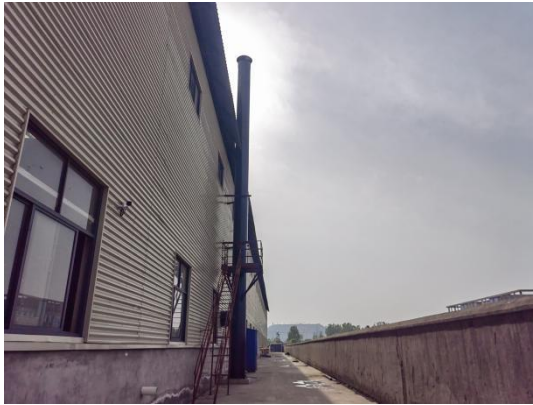
退火炉燃烧废气排气筒
