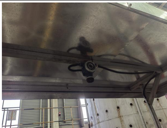
可燃气体和有毒有害气体报警装置
