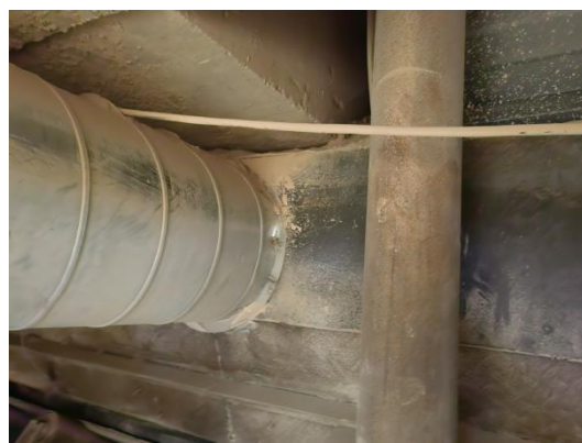
锤式破碎机落料收尘管道
