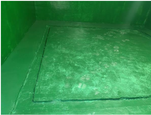
危废间导流沟
