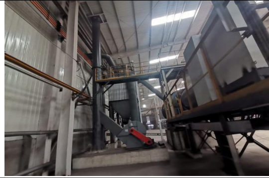
除尘器+排气筒 (P2)
