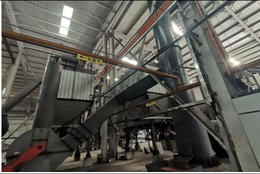
除尘器+排气筒 (P1)
