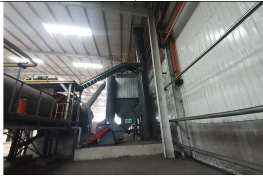
除尘器+排气筒 (P6)
