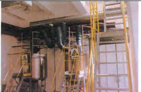
油相储罐废气收集-1
