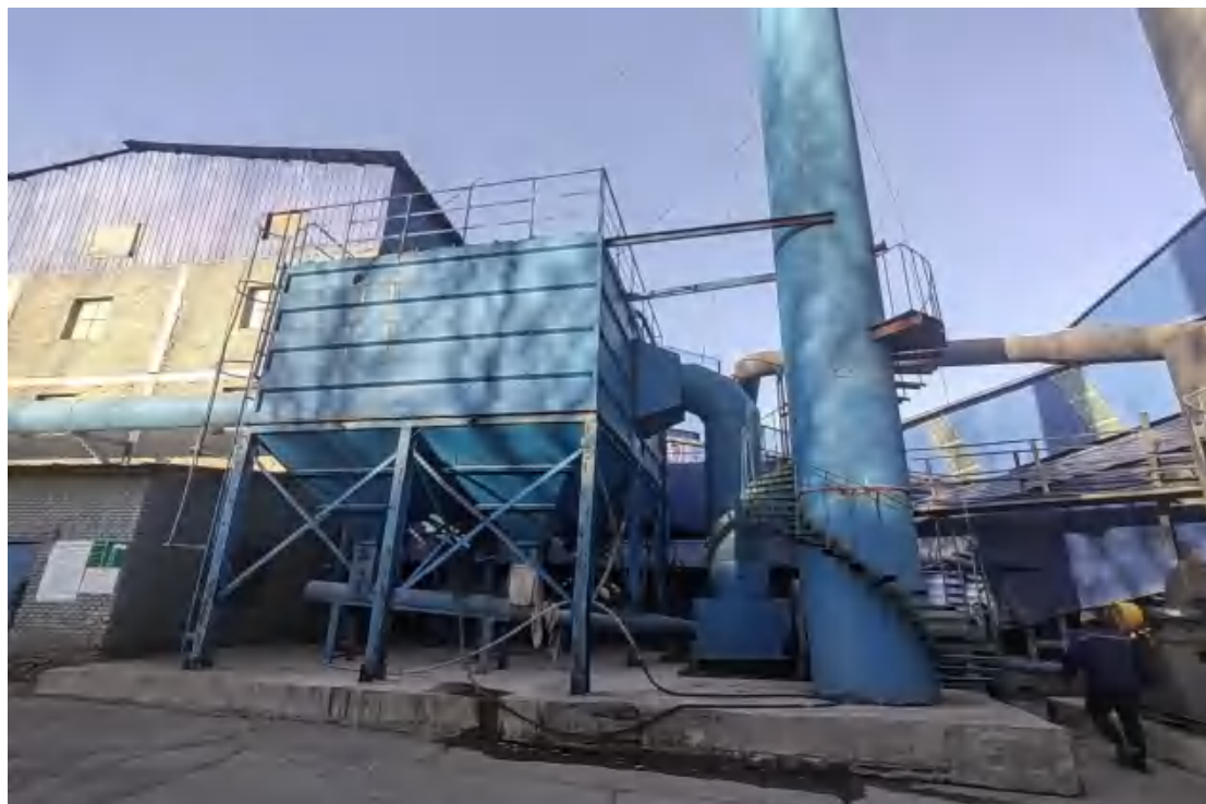
1#排气筒采样平台
