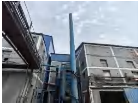
2#脉冲布袋除尘器+24m 排气筒
