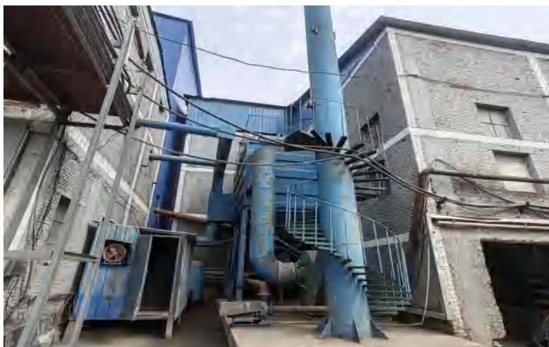
2#排气筒采样平台
