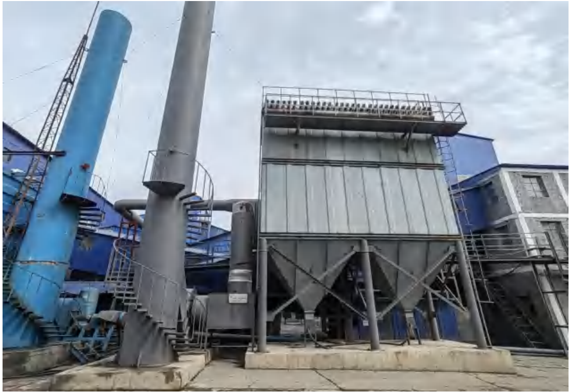
3#排气筒采样平台
