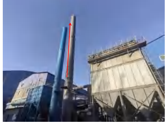
3#脉冲布袋除尘器+24m 排气筒
