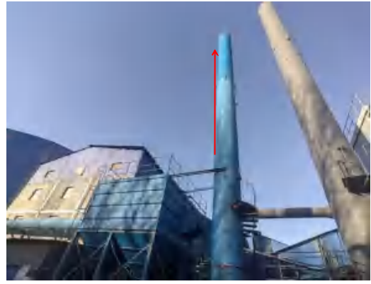
1#脉冲布袋除尘器+24m 排气筒
