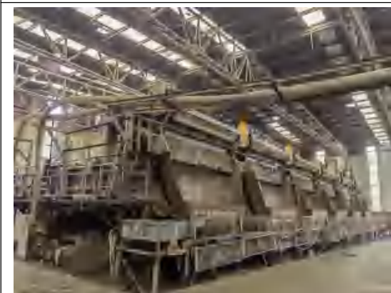
尾矿处理系统（带式压滤机）
