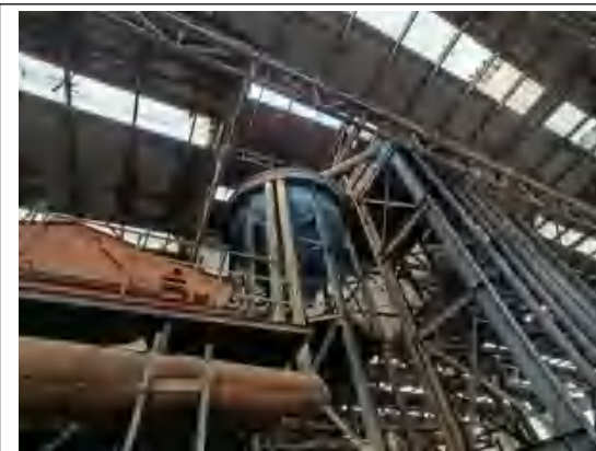
尾矿处理系统（浓密罐）
