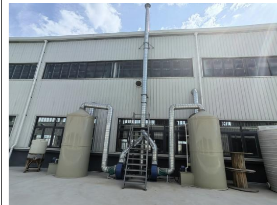
水吸收装置+排气筒
