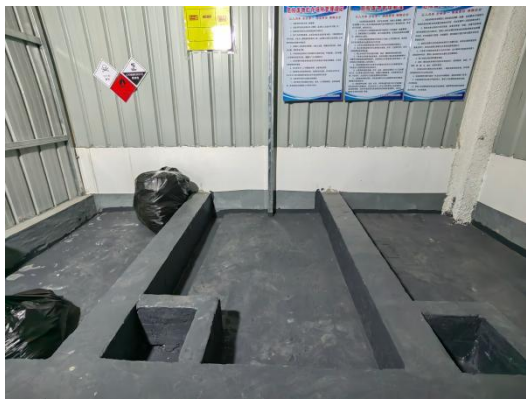
危废间内分区
