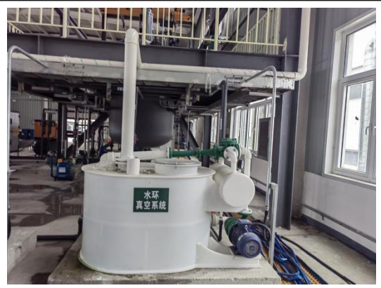
水环真空泵废气管道
