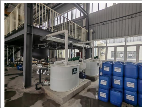
水环真空泵废气管道
