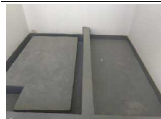
危废间分区+围堰
