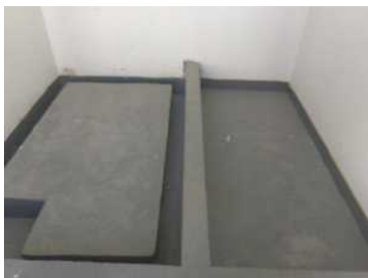
危废间分区+围堰
