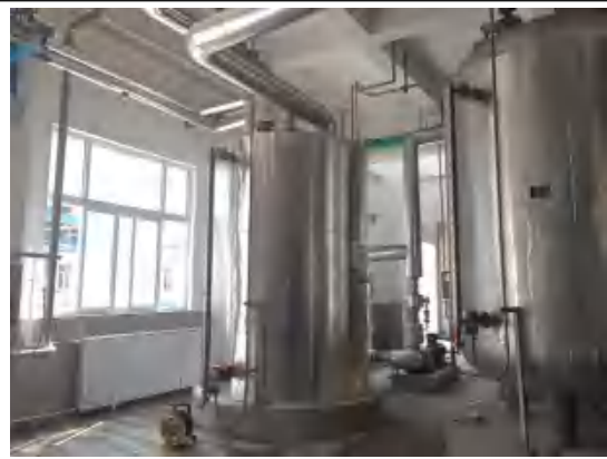
蒸汽凝液储罐
