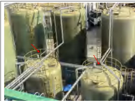
脱色储罐集气管道
