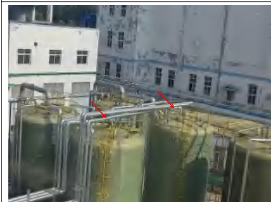
原液储罐集气管道
