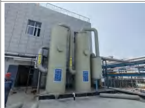
尾气吸收系统（一级稀硫酸喷淋+一级水喷淋）
