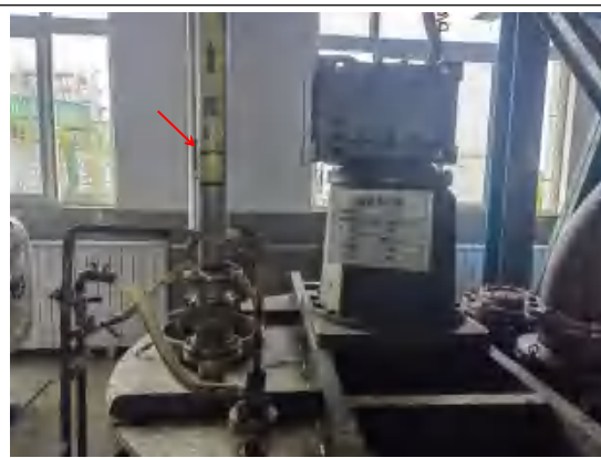
硫铵结晶集气管道
