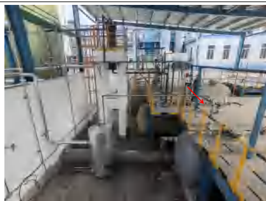
氨水储罐集气管道
