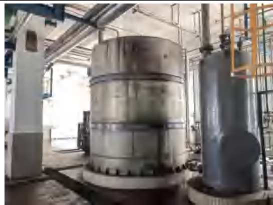
硫氰离心液储罐
