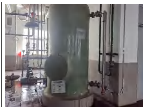
机封冷却水储罐
