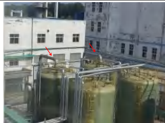
氧化罐集气管道
