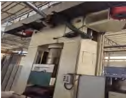
压力机集气管道
