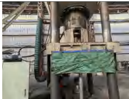
油压机集气管道
