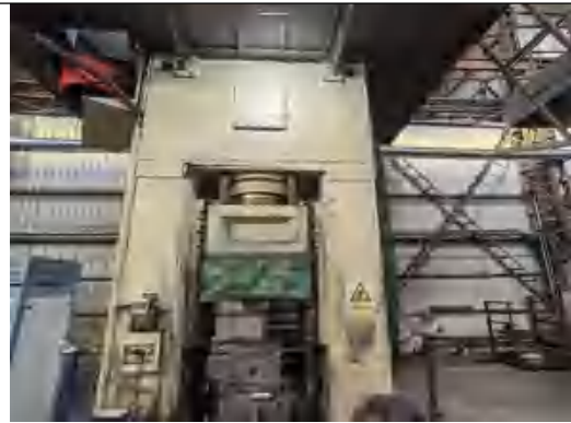
压力机集气管道
