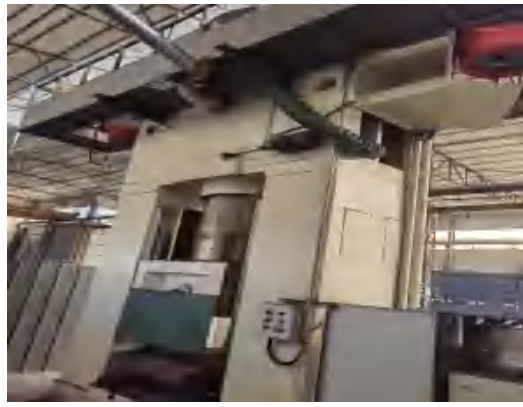
压力机集气管道
