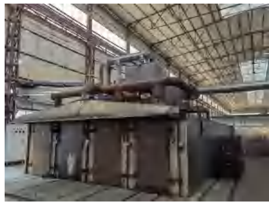
干燥系统北侧废气收集
