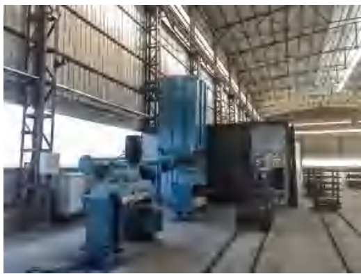
磨平废气收集+除尘器
