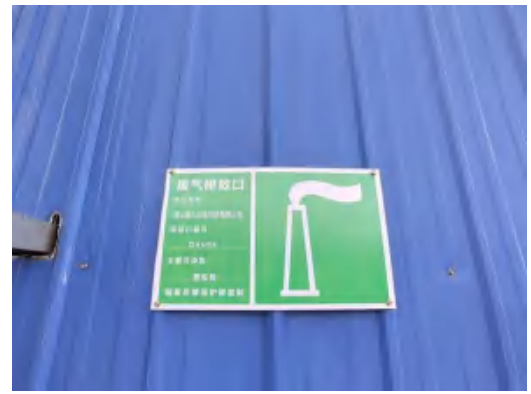
排放口标识牌
