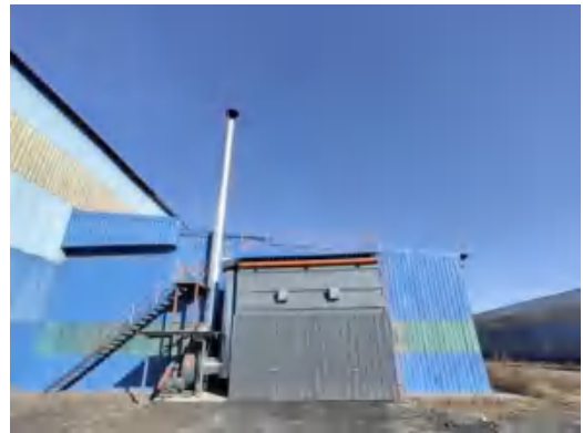
布袋除尘器+排气筒
