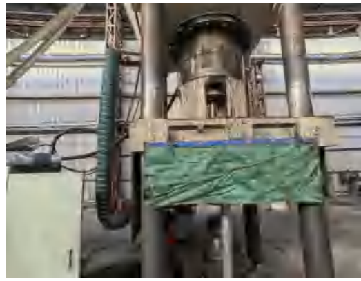
油压机集气管道
