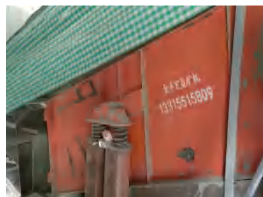
1#废料综合利用系统设备基础减振
