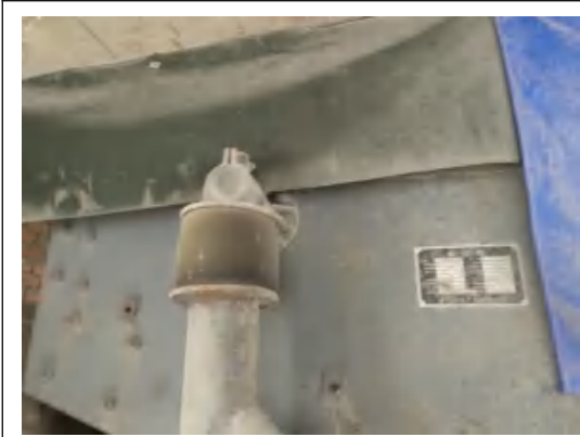
2#废料综合利用系统设备基础减振
