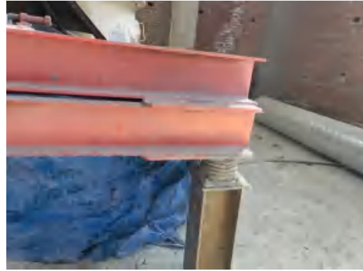
2#废料综合利用系统设备基础减振
