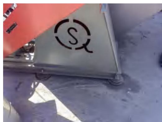
1#废料综合利用系统设备基础减振
