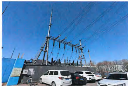
110kV 郝九线路 220kV 变电站出线
