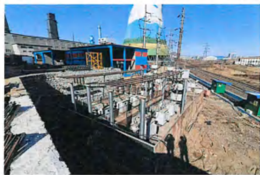
110kV 东变电站
