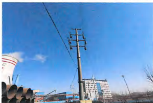
110kV 焦联线路
