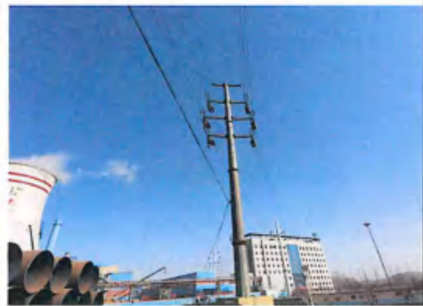
110kV 焦联线-南侧办公楼
