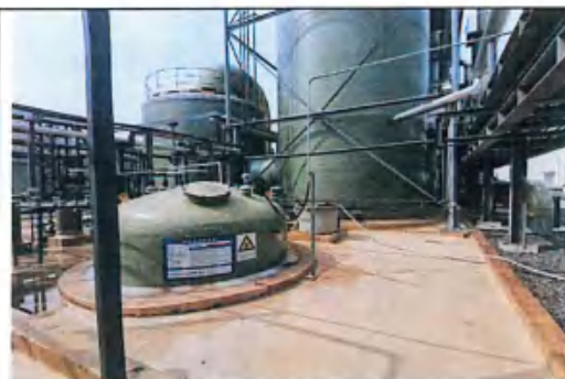
吹气机组装置区
