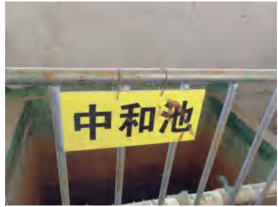
污水处理站中和池
