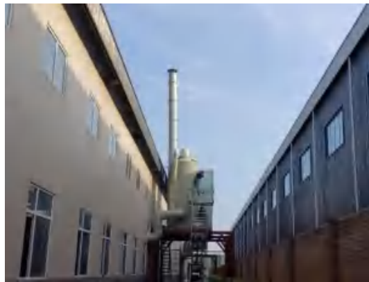
冷凝+碱雾、酸雾吸收净化塔
