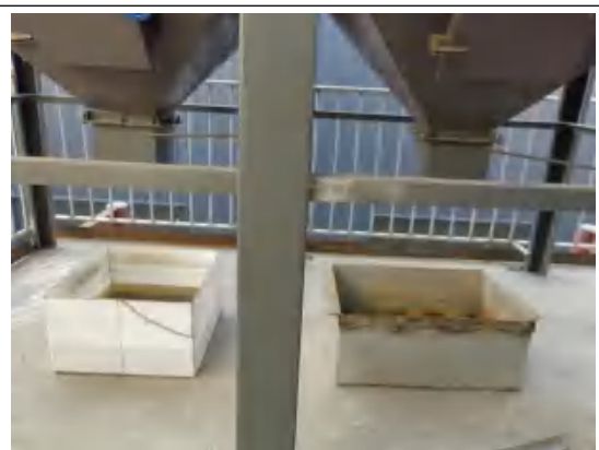
除尘灰收集槽
