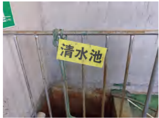
污水处理站清水池
