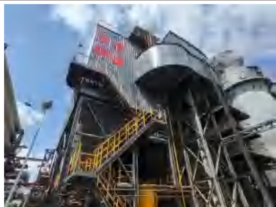
热风炉废气配套布袋除尘
