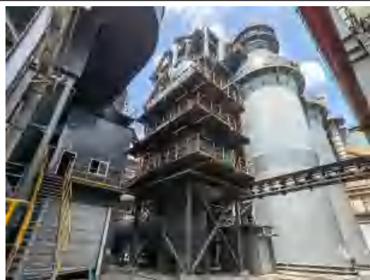
热风炉废气配套 SCR 脱硝
