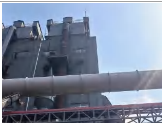
喷煤废气布袋除尘器
