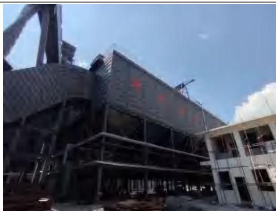
出铁场废气布袋除尘器（北）
