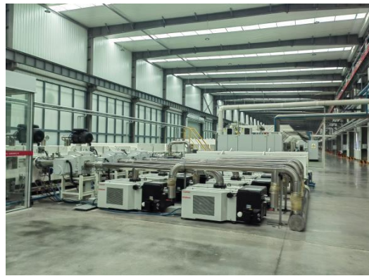
离线镀膜玻璃生产线
