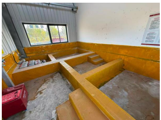
危废间内分区
