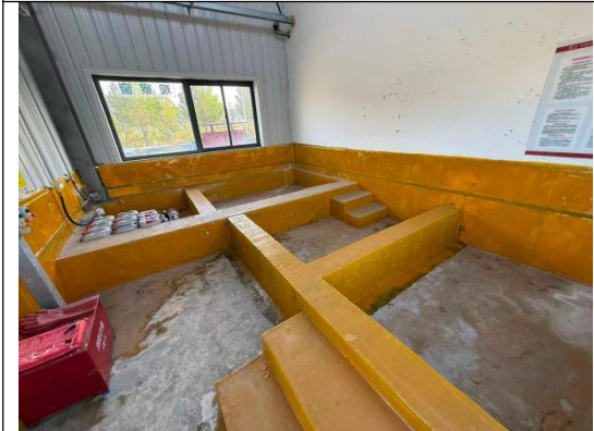
危废间内分区
