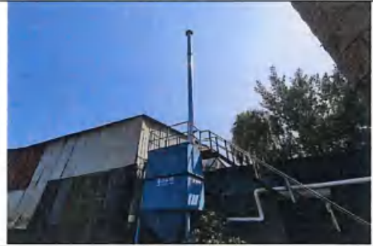
除尘器+排气筒
