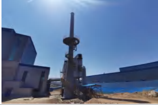
配套脉冲布袋除尘器+排气筒
