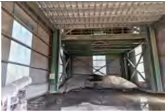
精矿石卸料封闭及喷雾
