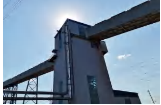
干选工序收尘管道
