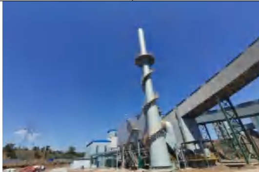
配套脉冲布袋除尘器+排气筒
