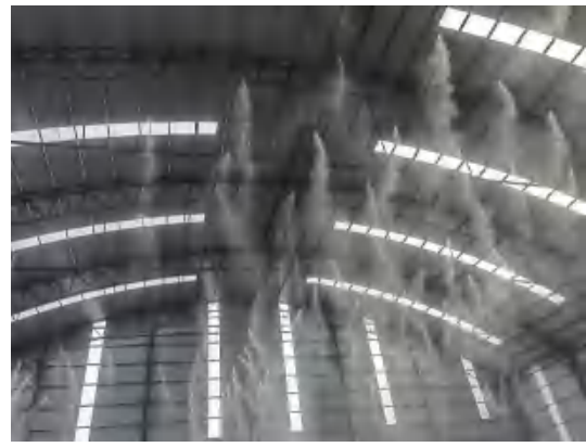
料棚内喷雾抑尘设施
