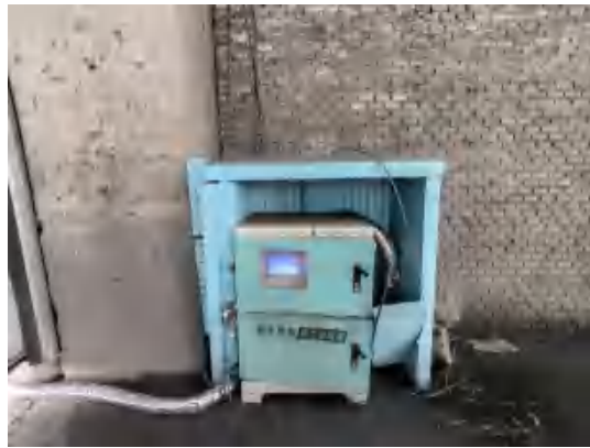
高压喷雾控制系统
