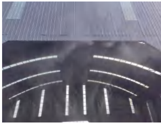
料棚西侧进出口喷雾抑尘设施
