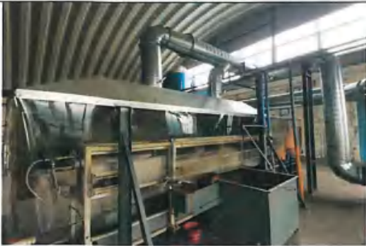
冷却废气 1-密闭集气装置+管路
