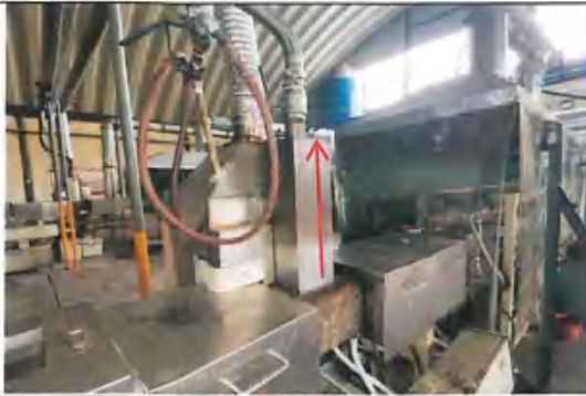
塑化、挤出-密闭集气装置+管路
