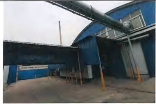
电加热热力焚烧装置+排气筒
