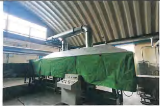
冷却废气 2-密闭集气装置+管路
