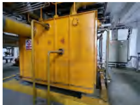
主油箱碳钢防渗漏材质+围堰
