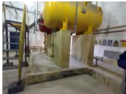
酸碱储罐围堰
