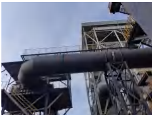
煤气管道设有识别色和流向
