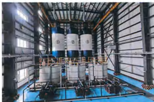
石灰仓除尘器
