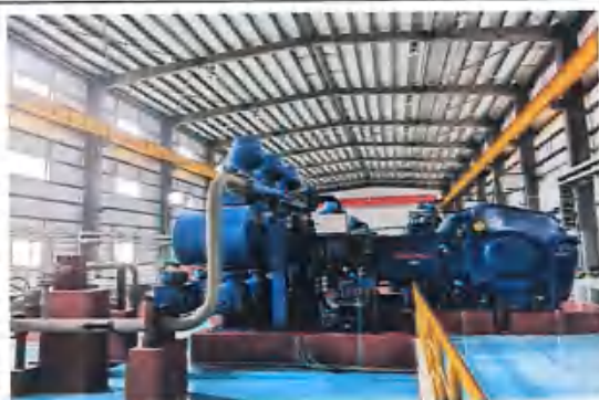
起点输送泵站
