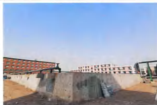
事故池-终端站
