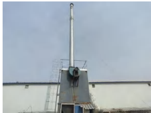
3#脉冲布袋除尘器+15m 高排气筒
