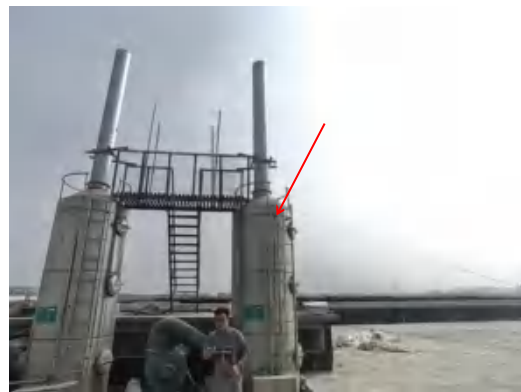
2#二级水喷淋装置
