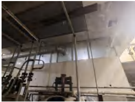
配胶工序封闭收集+集气管道
