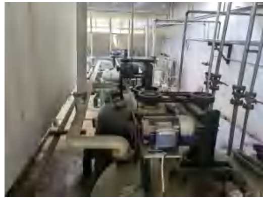
熬胶工序收集管道
