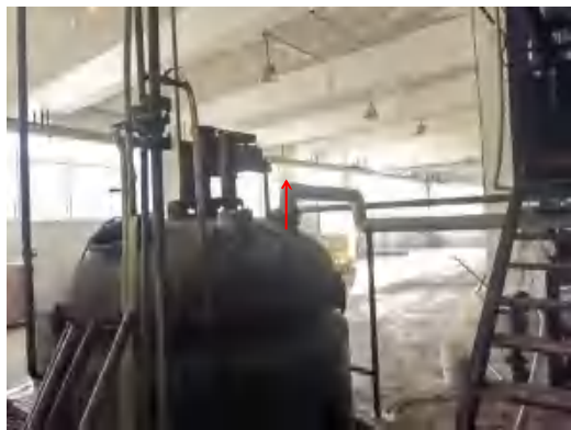
熬胶工序收集管道
