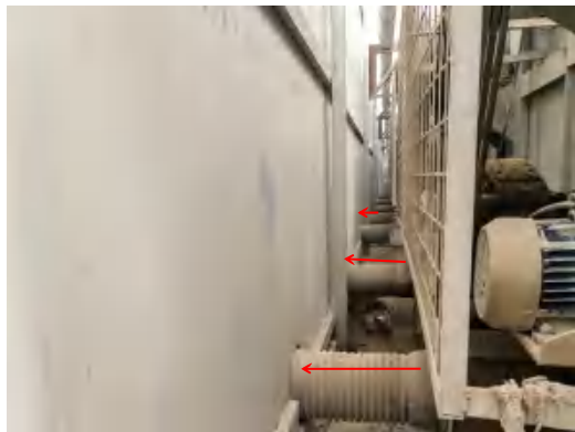
脱模之后的烘干工序收尘管道
