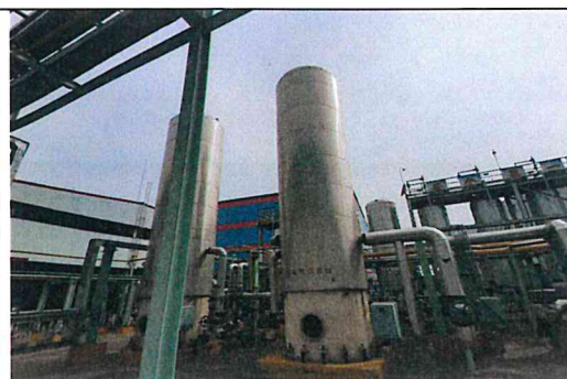
顺放气混合罐
