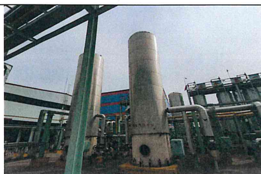
解吸气混合罐
