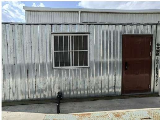
一体化污水处理间
