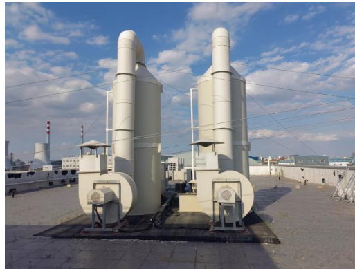
1#2#活性炭箱+喷淋塔
