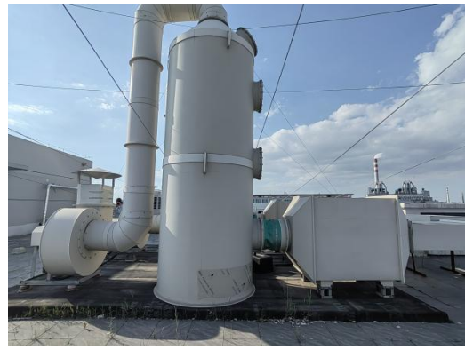
2#活性炭箱+喷淋塔
