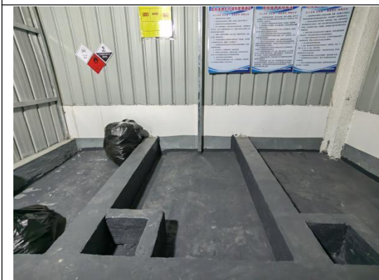
危废间内分区
