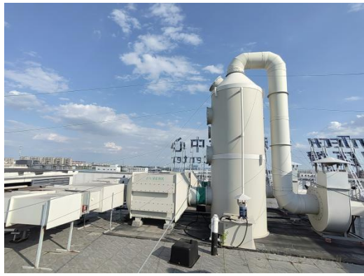
1#活性炭箱+喷淋塔
