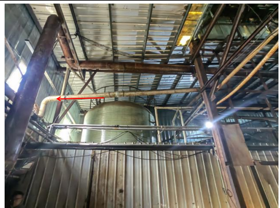
盐酸储罐呼吸口集气管道
