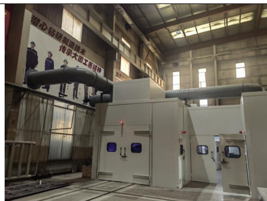
封闭式等离子喷涂房
