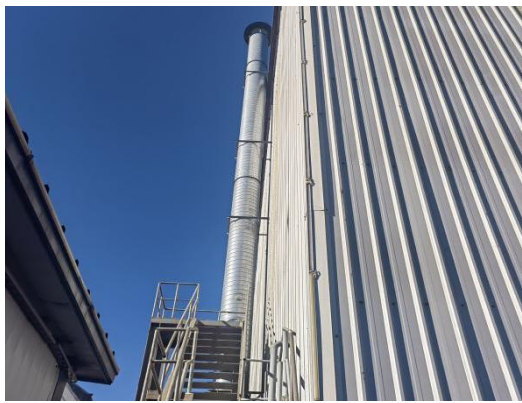
喷砂房滤筒除尘器排气筒
