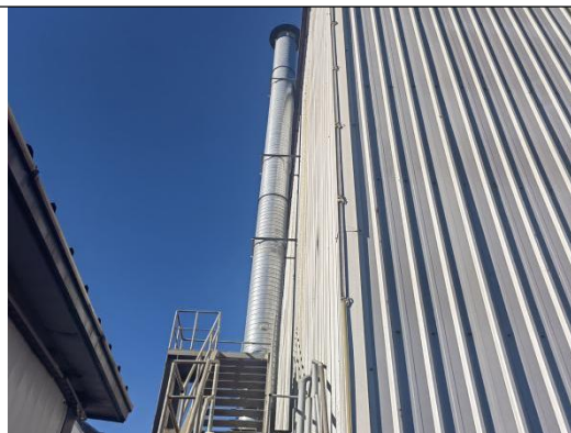
喷砂房滤筒除尘器排气筒
