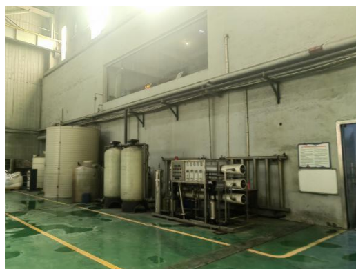
厂区现有污水处理站
