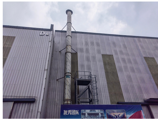
酸雾吸收塔排气筒
