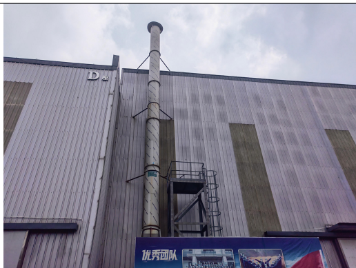
酸雾吸收塔排气筒
