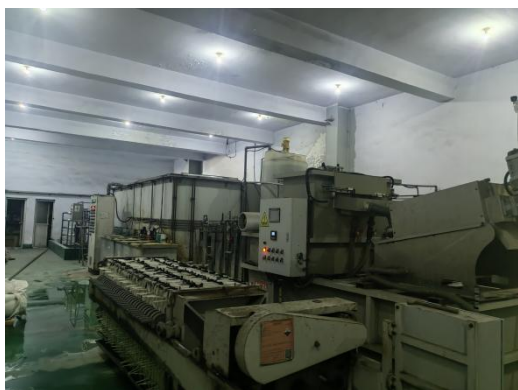
厂区现有污水处理站
