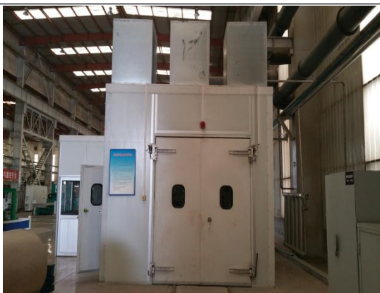
封闭式铜板修复喷涂房
