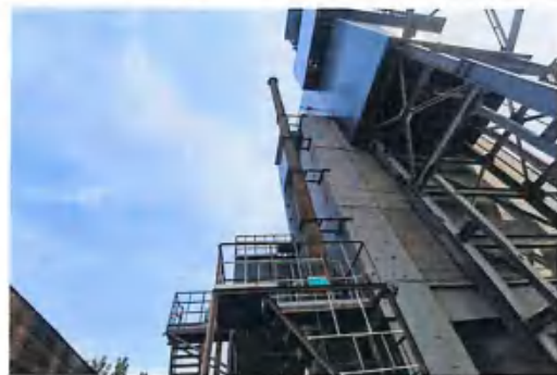
箕斗仓除尘器+排气筒 (P3)
