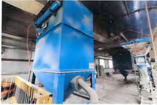
料仓+搅拌机除尘器
