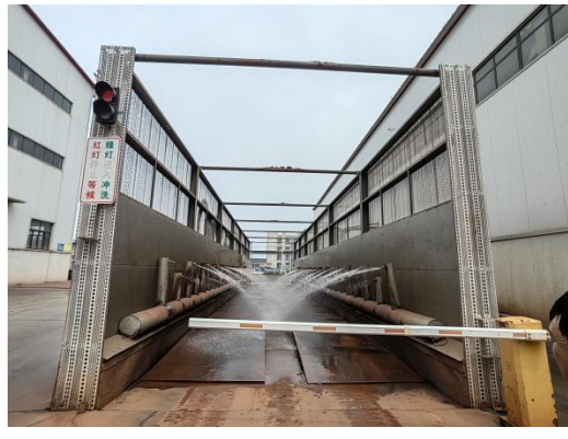
厂区出口洗车设施
