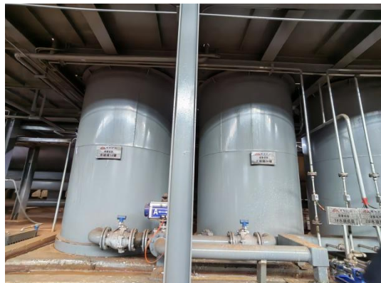
药剂制备槽（S-02）
