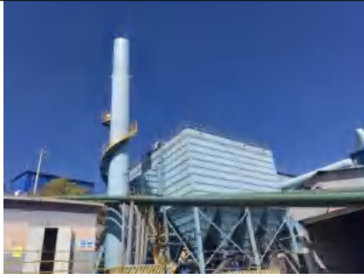
脉冲布袋除尘器+20m 排气筒
