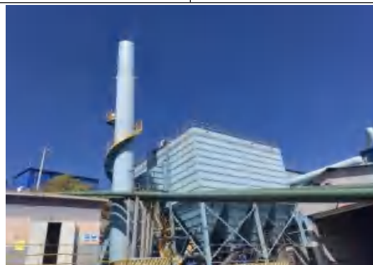
脉冲布袋除尘器+20m 排气筒
