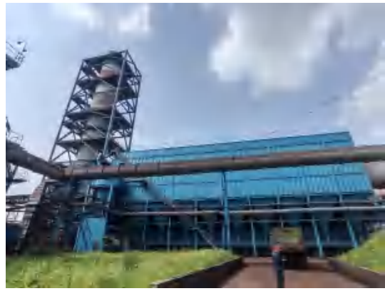
新 1#转炉三次烟气布袋除尘器+排气筒
