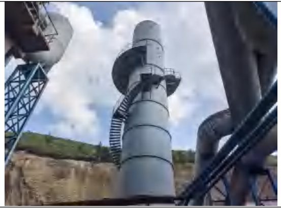
新 2#转炉二次烟气布袋除尘器排气筒
