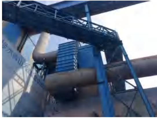
新 1#转炉散装料上料及转运工序布袋除尘器
