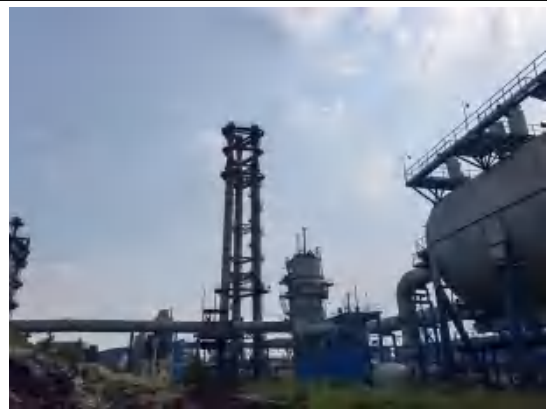
新 1#转炉一次烟气 LT 干法除尘排气筒
