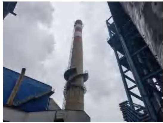
热风炉 71m 排气筒
