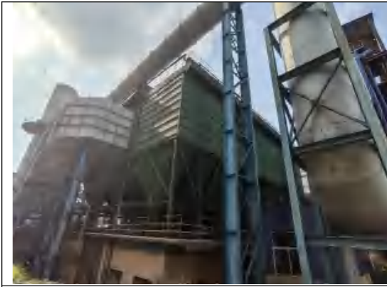
新 2#转炉二次烟气布袋除尘器
