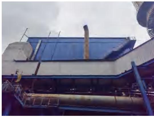
热风炉废气 SDS 干法脱硫+布袋除尘
