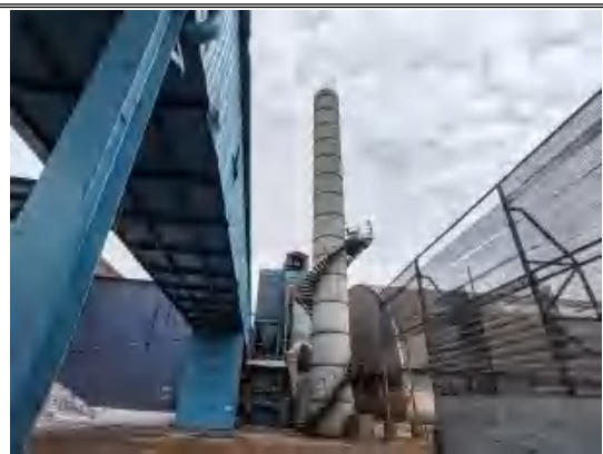
焦炭上料及转运布袋除尘器
