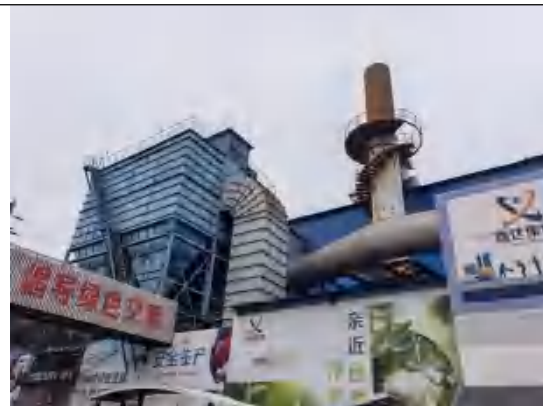
矿槽槽上转运布袋除尘器
