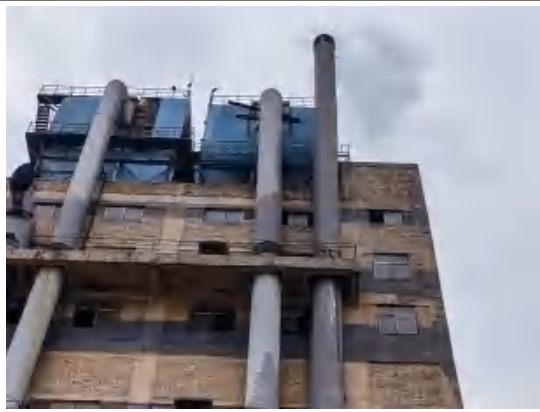
喷煤废气布袋除尘器
