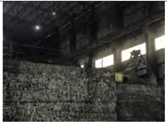
原料库内喷雾抑尘设施
