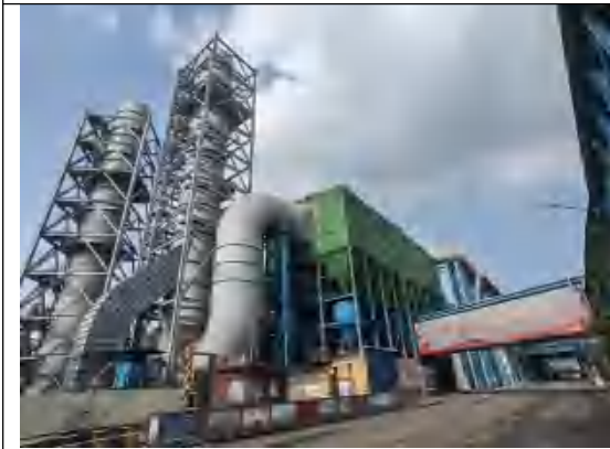
新 2#转炉三次烟气布袋除尘器+排气筒
