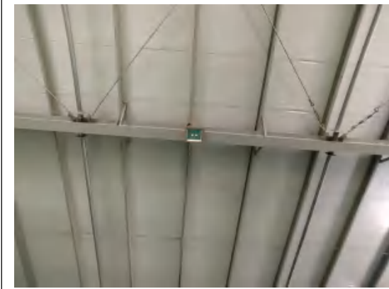
危废间内防爆灯
