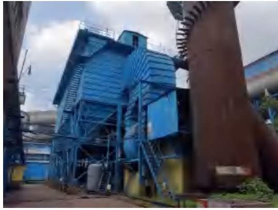
新 1#转炉二次烟气布袋除尘器
