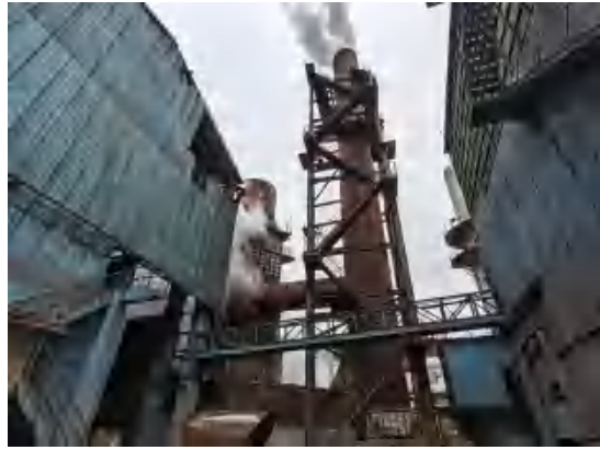
重力旋流除尘+降温+升温
