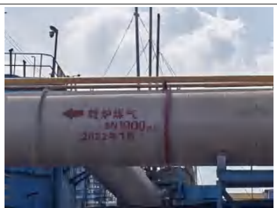
煤气管道流向标识
