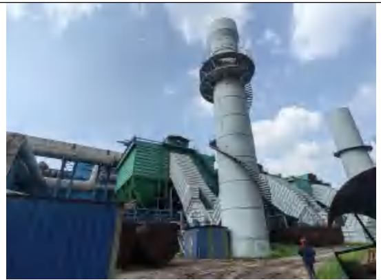
新 2#转炉散装上料转运及连铸切割工序布袋除尘器+排气筒
