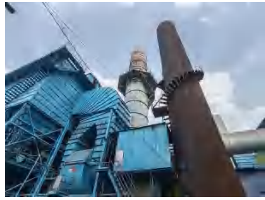
新 1#转炉二次烟气布袋除尘器排气筒
