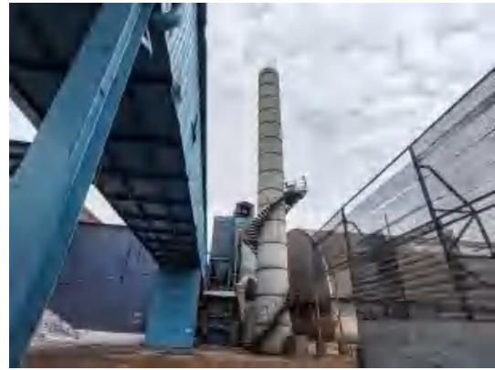
焦炭上料及转运布袋除尘器
