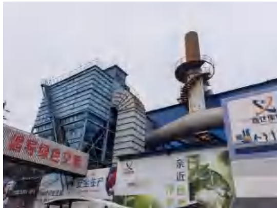
矿槽槽上皮带转运布袋除尘器
