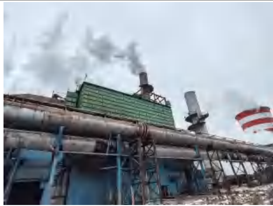
出铁场废气布袋除尘器
