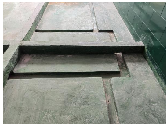
危废间导流沟
