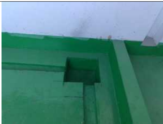
危废间导流沟、集液池
