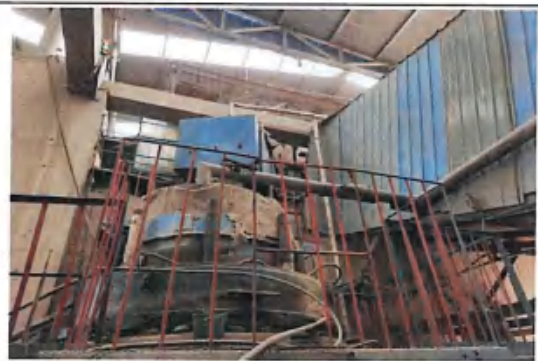
圆锥破碎入口集尘+喷淋
