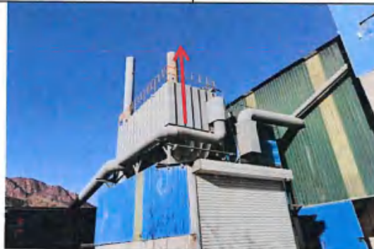
除尘器及排气筒
