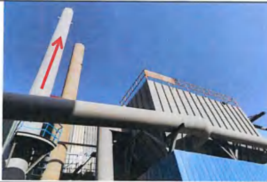
除尘器及排气筒
