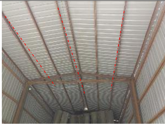
南侧上料仓喷淋设施
