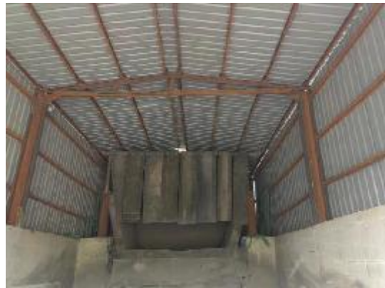
南侧上料口软帘+集气罩
