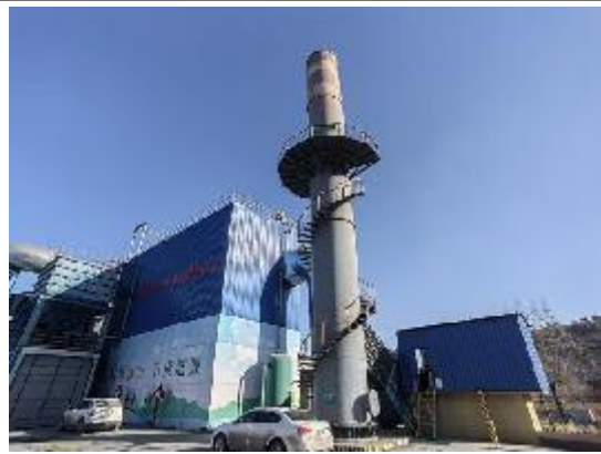
脉冲布袋除尘器+排气筒
