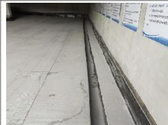
危废间导流沟
