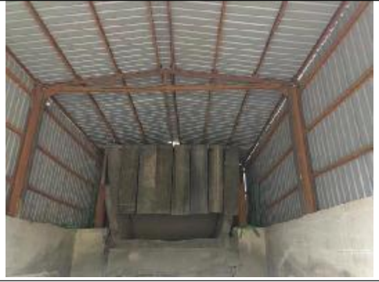
南侧上料口软帘+集气罩
