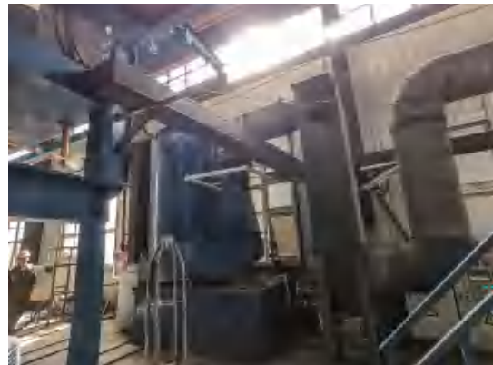
布袋除尘器+水喷淋塔吸收塔
