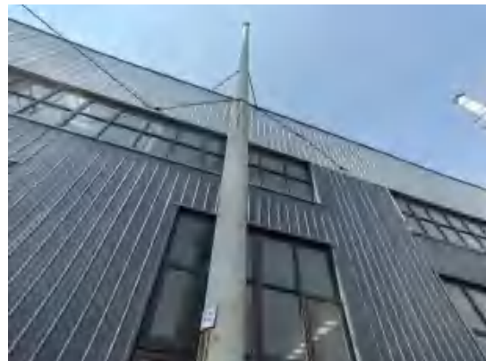
热处理炉 22m 高排气筒
