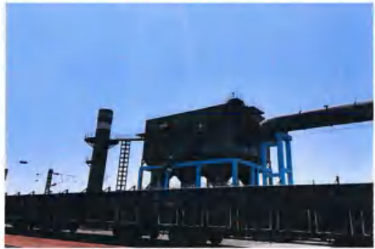
除尘器+排气筒
