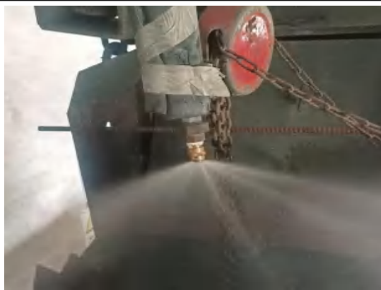
喷雾抑尘设施
