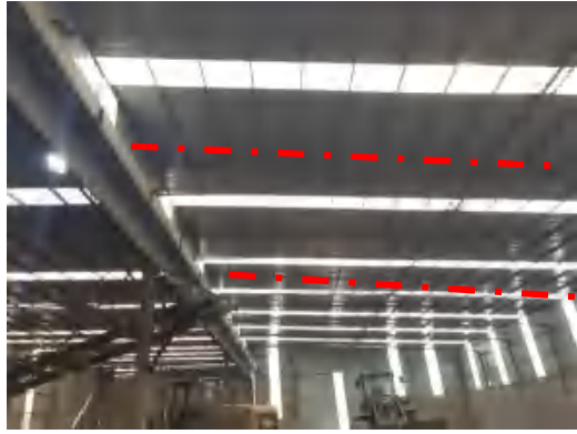
石矿库房喷淋
