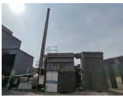
脉冲布袋除尘器+15m 排气筒
