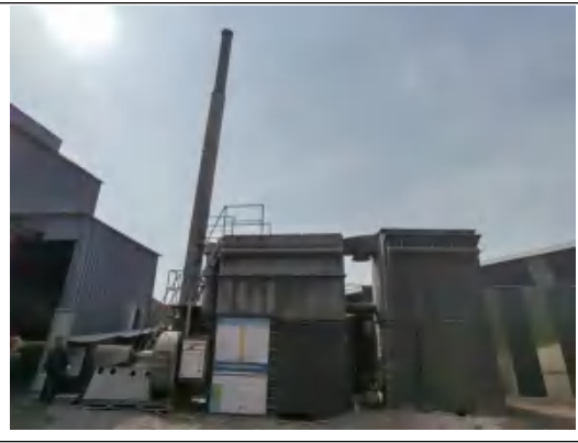
脉冲布袋除尘器+15m 排气筒
