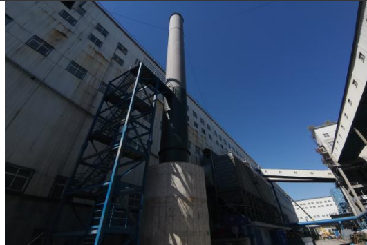
除尘器+排气筒
