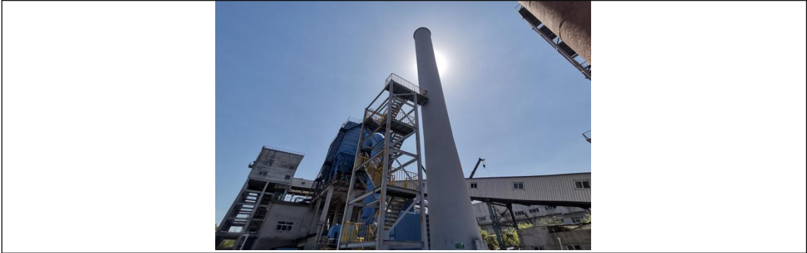
除尘器+排气筒
