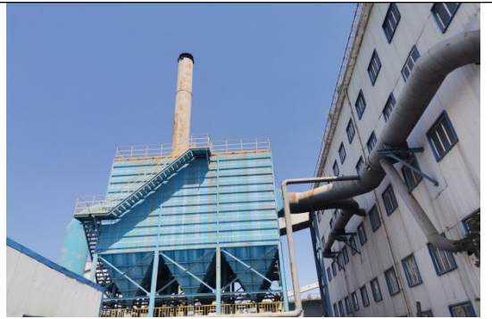
除尘器+排气筒
