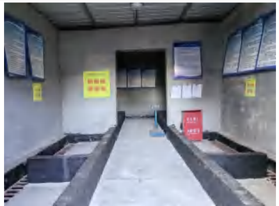
危废间内分区
