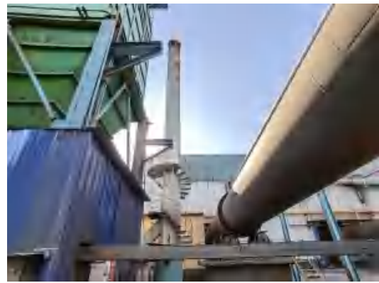
3#回转窑除尘器 25m 排气筒[P3]
