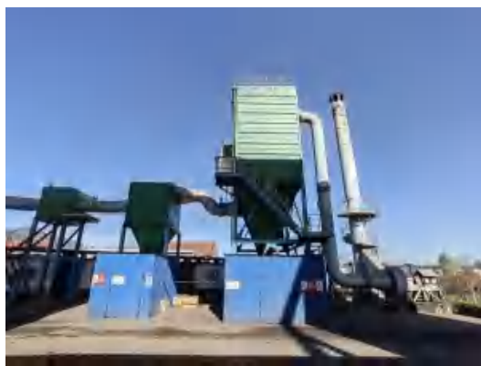
1#回转窑多管除尘器+脉冲布袋除尘器 +25m 排气筒[P1]
