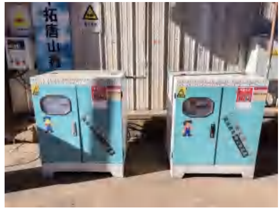
库房内高压喷雾系统
