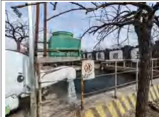
冷却水循环水池
