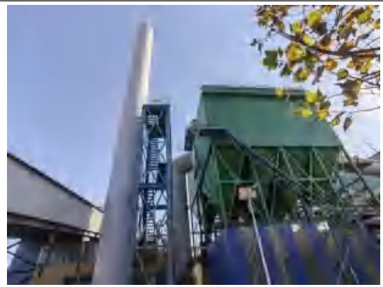
4#脉冲布袋除尘器 25m 排气筒
