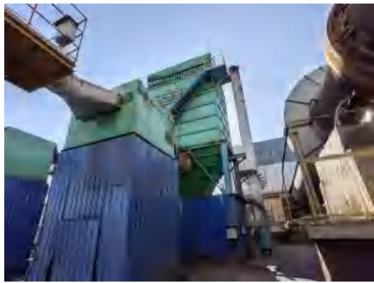
3#回转窑多管除尘器+脉冲布袋除尘器
