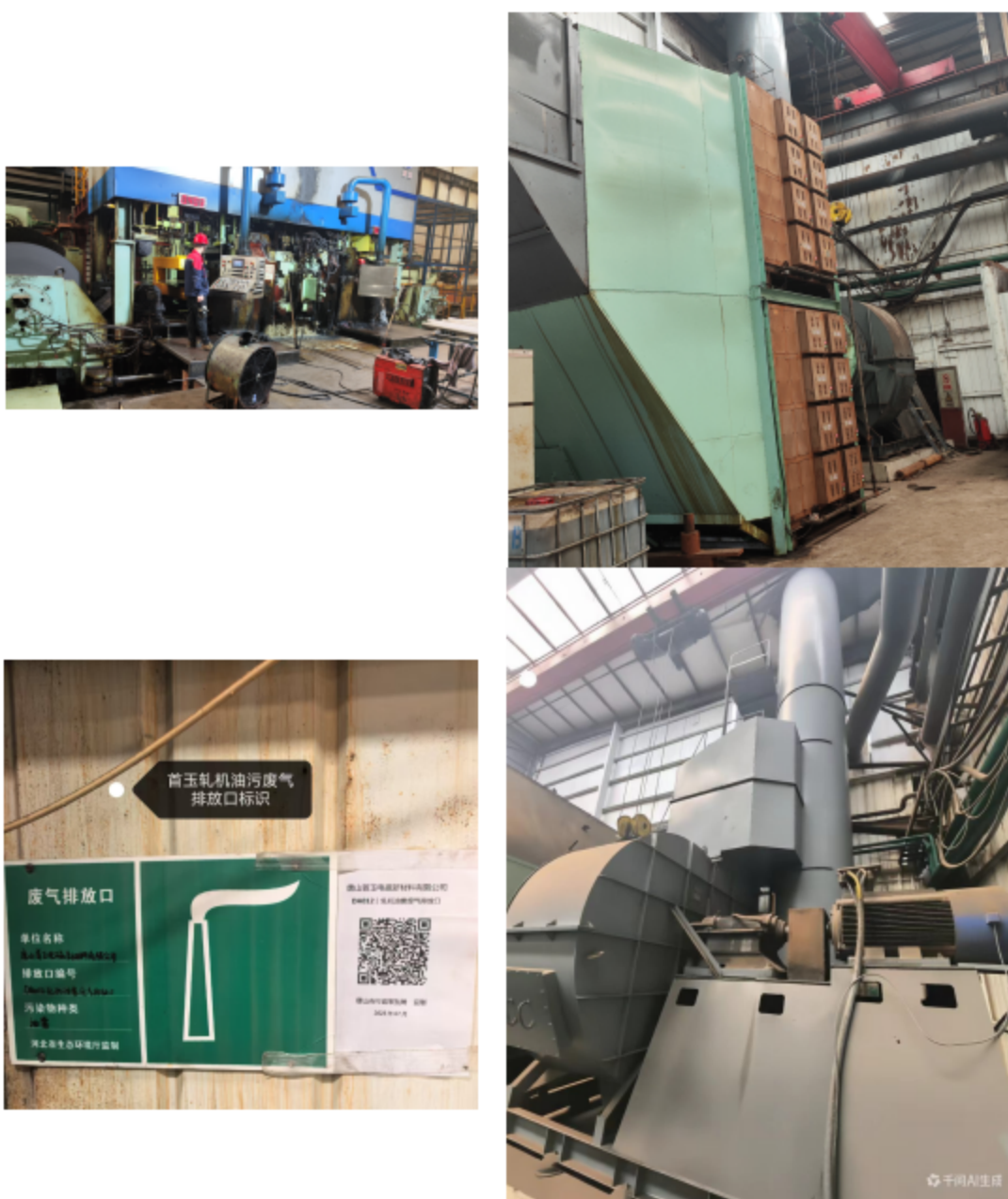
图 3 废气处理设施照片
