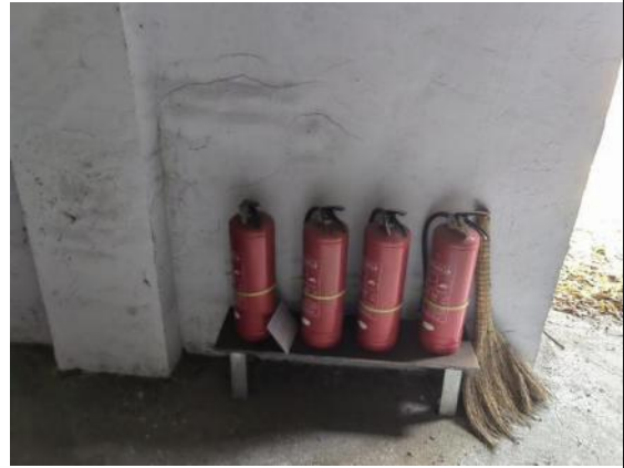
危废间消防设施
