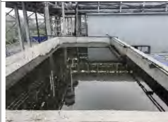
V 型过滤池
