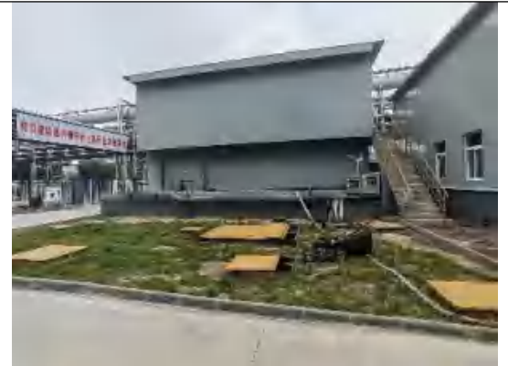
絮凝沉淀+A 2 /O 水池
