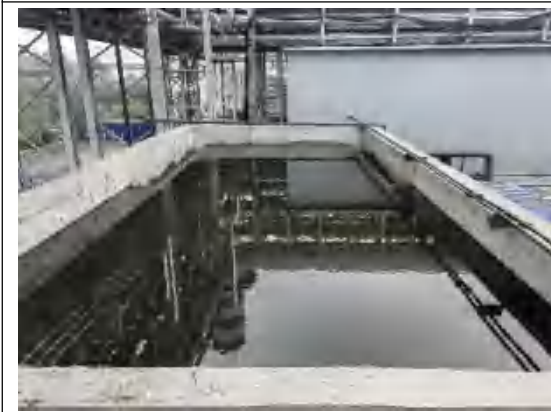
V型过滤池
