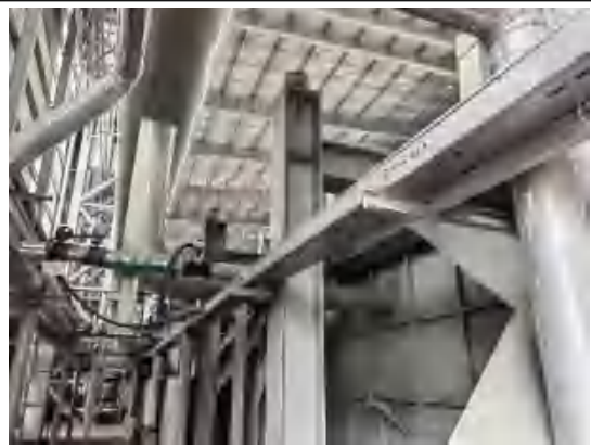
闷渣罐废气收集管道
