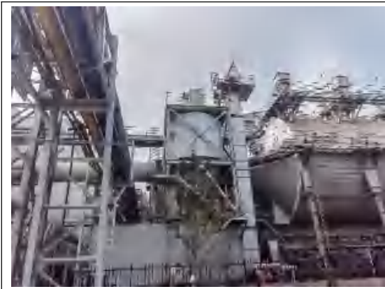
除尘灰密闭仓储存
