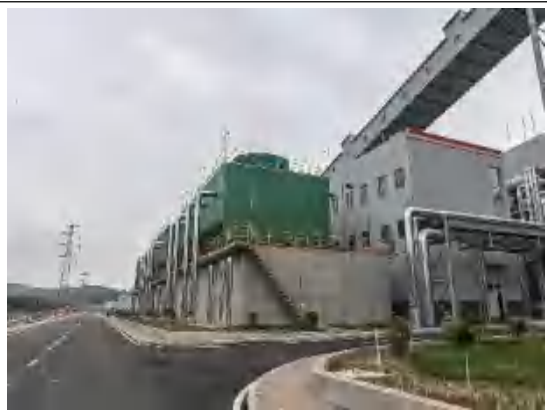
冷却循环水池
