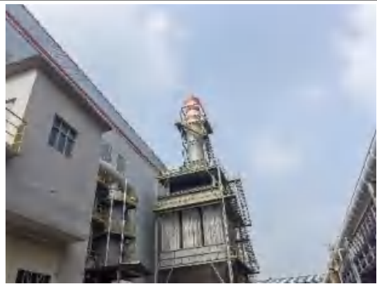
湿式电除尘器+39m 排气筒
