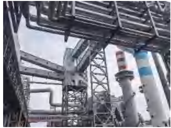
皮带转运点集气管道
